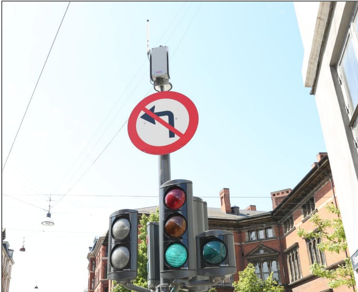
Vejsideenhed installeret i én af de i alt 21 signalreguleringer i København
